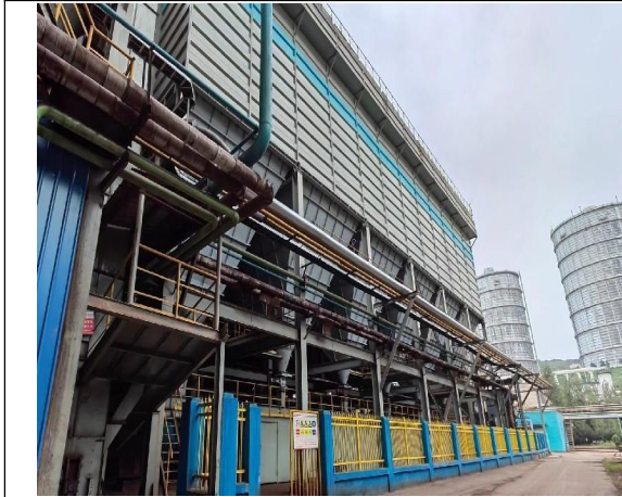
1#提钒转炉二三次烟气-布袋除尘器
