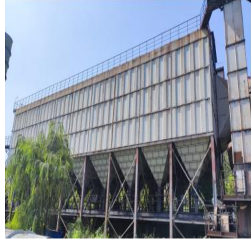
1#高炉-矿槽烟气-布袋除尘器
