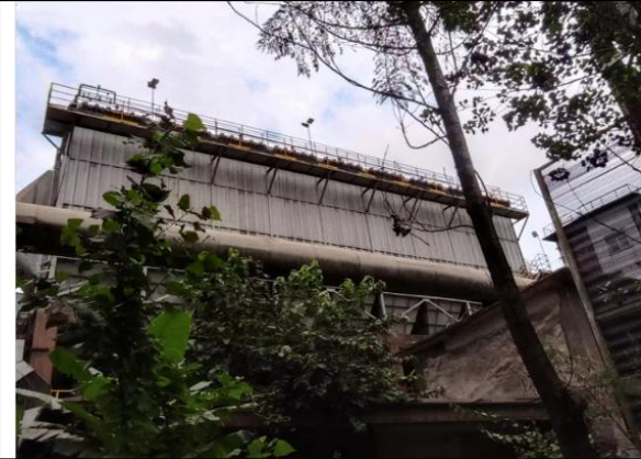
烧结机-整粒、筛分烟气-布袋除尘器
