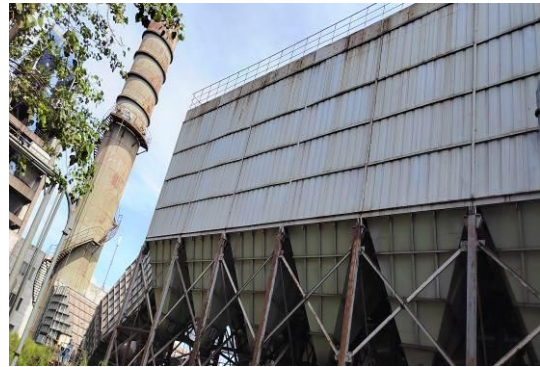
3#高炉-矿槽烟气-布袋除尘器
