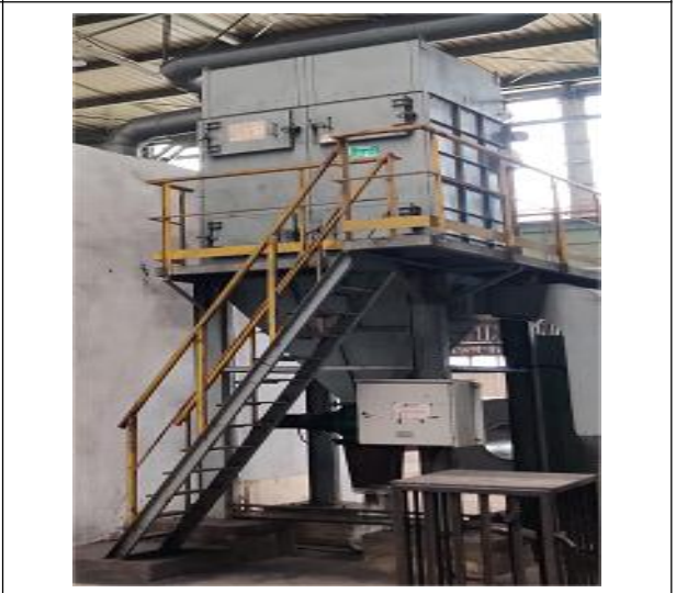
平整机组塑烧板除尘器
