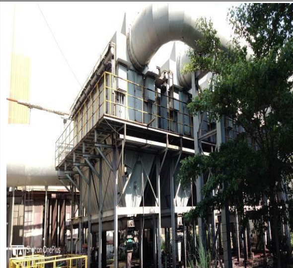
热轧生产线塑烧板除尘器
