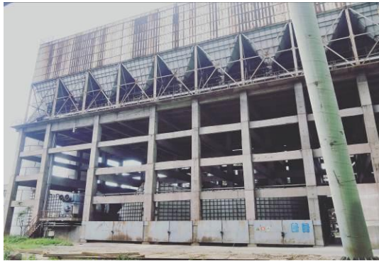
3#高炉-出铁场烟气-布袋除尘器
