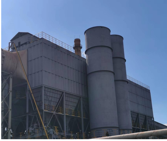
1#高炉-出铁场烟气-布袋除尘器
